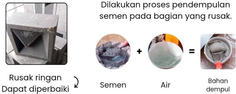
Gambar 1. 2Loaster Grade B – Rusak Ringan dan Proses Pendempulan
